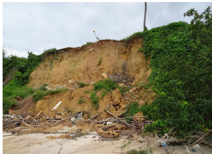
Figura 35: Solapamento da base e desmoronamento de barrancos (de 5 a 6 metros) que margeiam a Praia de Vila do Conde.
