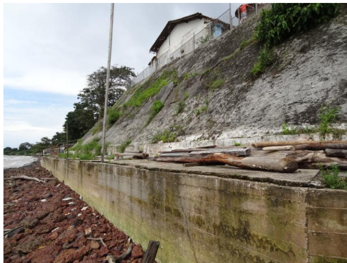
Figura 37: Aspecto do muro de contenção ao processo erosivo das marés. Ao alto, fundos da Igreja de São João Batista, Vila do Conde.
