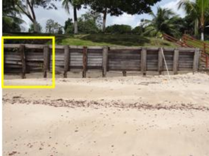
Figura 40: Estrutura de contenção com danos provocados pelo processo erosivo.
