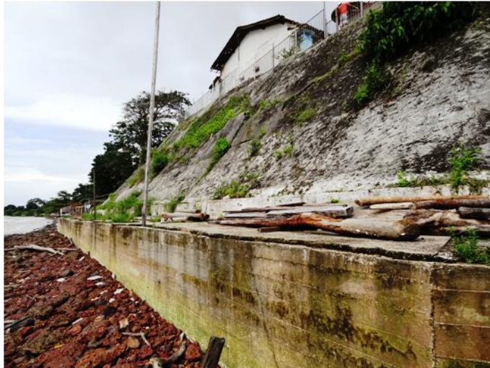
Figura 20: Estrutura artificial construída em concreto, praia de Vila do Conde.
